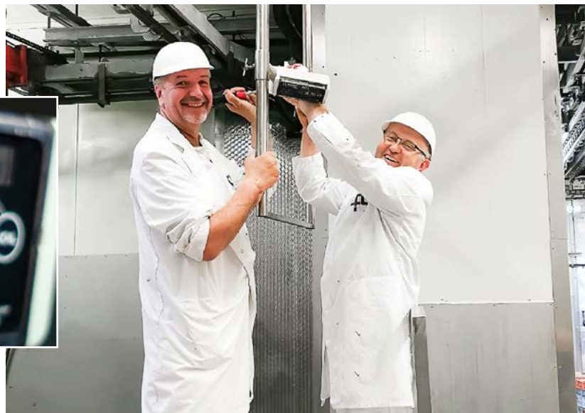
Installation der CLASSIFAI Box® für eine KI-unterstützte Rinderklassifizierung in Österreich.
